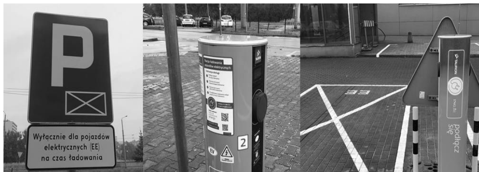
Rys. 1. Stacja ładowania pojazdów elektrycznych w Tychach
